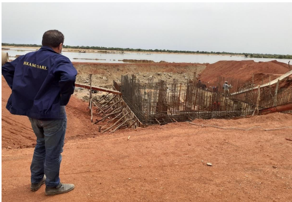
Station de pompage Figuiratomo-Travaux arrêtés
