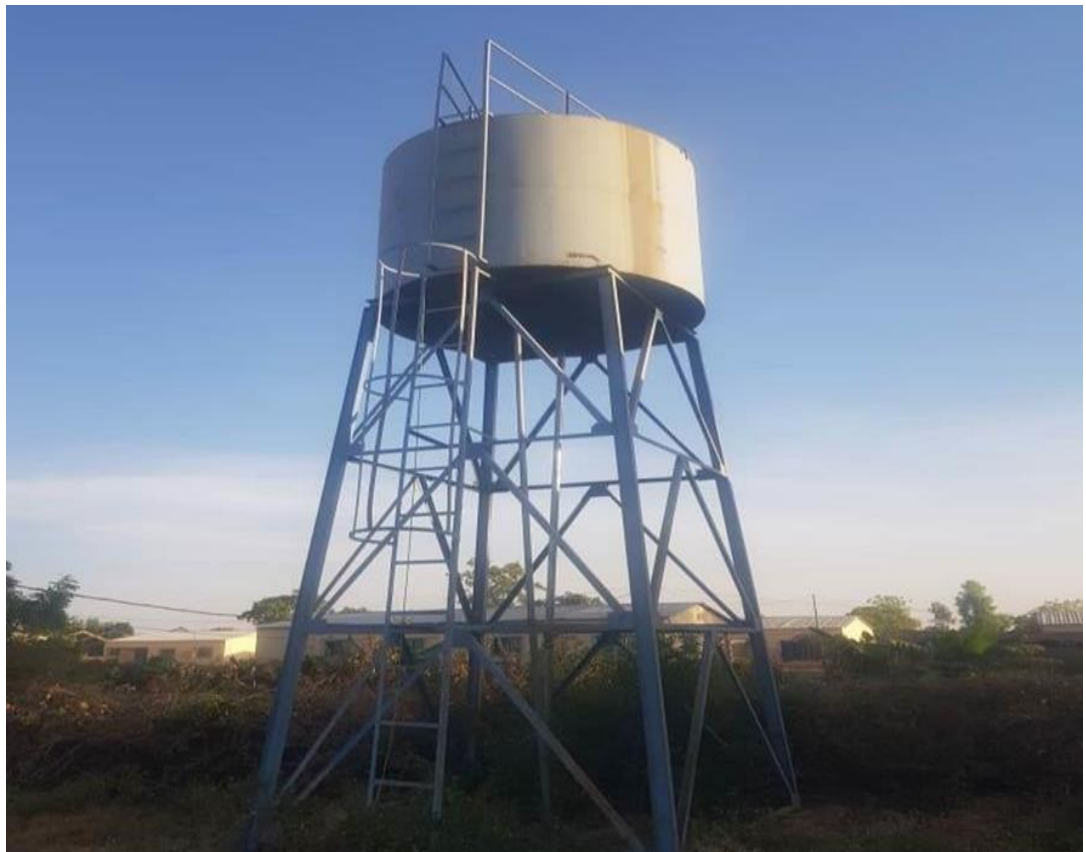
Site de Molodo : Château d'eau fonctionnel dans la cour de la cité de l'office du Niger
